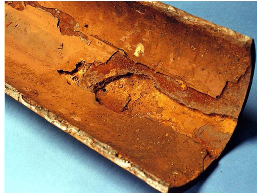
Linha de incêndio corroída
