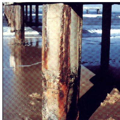
Fig. 06 – Estaca de concreto armado com manchas de corrosão.
