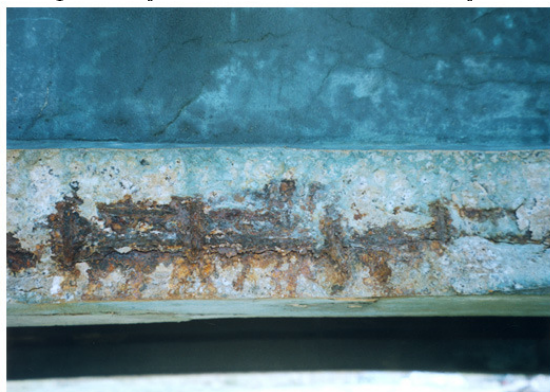
Fig. 02 - Laje de concreto (a) e costado de tanque em concreto (b) com presença manchas de eflorescências e com formação de estalactites resultantes da lixiviação de compostos do cimento e de sua reação química com o CO 2 atmosférico e com a presença de manchas de lixiviação de produto de corrosão.
