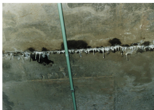
Fig. 04 – Laje de concreto com presença manchas de eflorescências e com formação de estalactites resultantes da lixiviação de compostos do cimento e de sua reação química com o CO 2 atmosférico e com a presença de manchas de umidade resultante dessa reação química e de possível infiltração de água pela junta.
