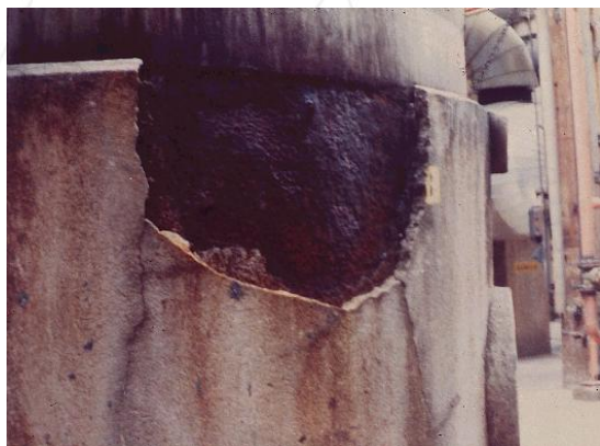
Fig. 08 – Corrosão sob revestimento com concreto para proteção passiva corta fogo (Cortesia IEC Engenharia)
