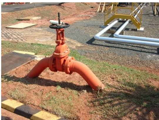
Fig. 05 – Válvula e interface aéreo/enterrado (Cortesia IEC Engenharia)
