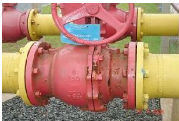
Fig. 04 - Flanges e parafusos (Cortesia IEC Engenharia)
