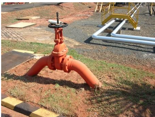
Fig. 05 – Válvulas e interface aérea/enterrado (Cortesia IEC Engenharia)
