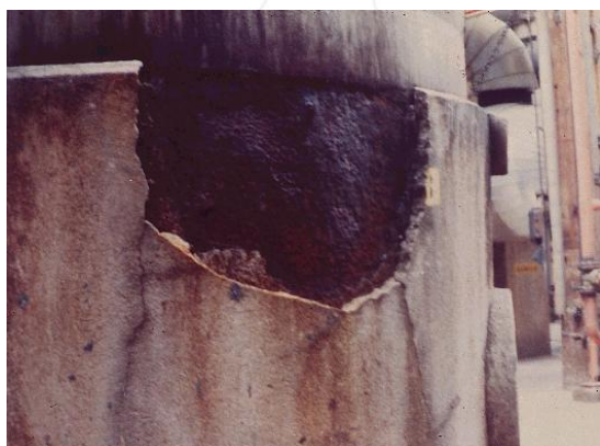
Fig. 08 – Corrosão sob revestimentos com concreto para proteção passiva corta fogo (Cortesia IEC Engenharia)
