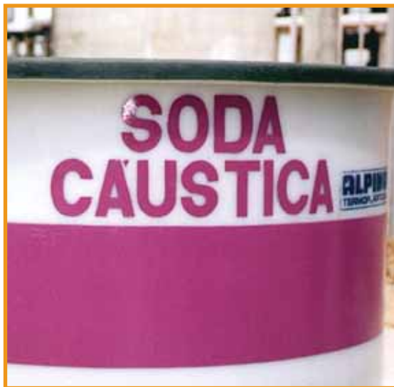
Figura 17 – Pintura de tanque para produtos alcalinos com tinta branca e faixa púrpura
