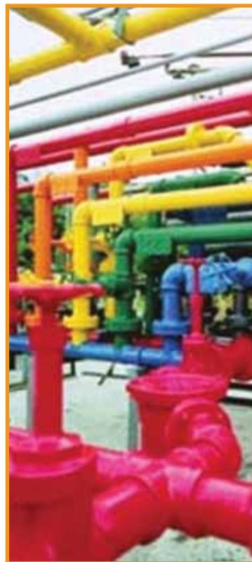
Figura 12 – Exemplo de tubulações industriais pintadas com cores padronizadas (ABNT NBR 6493)
