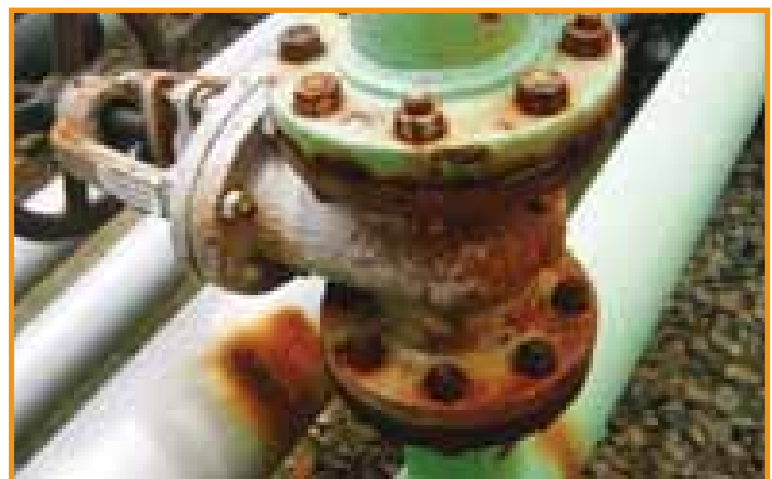
Figura 2 – Válvula de gaveta com corrosão acentuada
