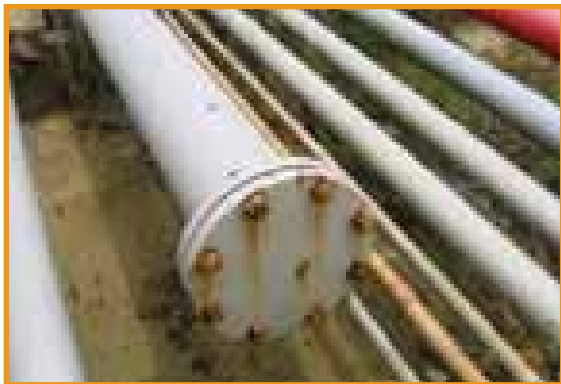
Figura 3 – Flange cego com focos de corrosão
