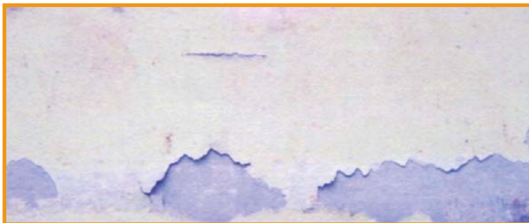
Figura 4 – Falha de sistema composto de tinta rica em zinco, por cura deficiente da tinta de fundo
