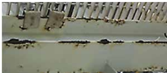
Figura 3 - Corrosão nas arestas vivas de uma Viga de aço
