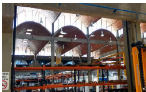
Figuras 3 e 4 - Área interna das oficinas com visualização das aberturas zenitais - Fonte: Autores (2017)
