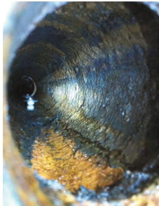
Figura 6: Vista interna da seção do tubo logo após a curva.
