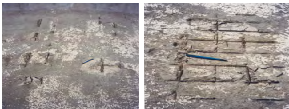
Figuras 7 e 8 - Exposição de armaduras no dorso da abóboda - Fonte: Autores (2017)
