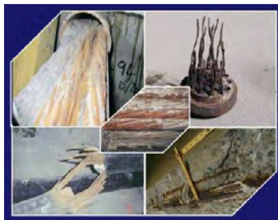
Figura 3: Cabos Pós-Tensionados com Problemas Sérios de Corrosão, Situação Comum de ser Encontrada e Pontes e Estruturas em Operação.
