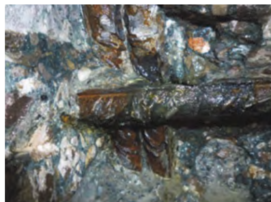
Figura 5. Corrosão negra. Fonte: (11)
