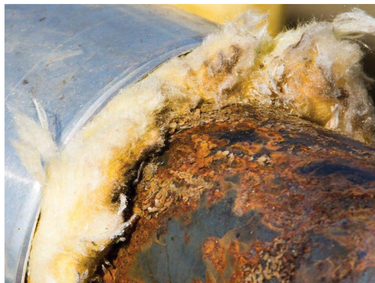
Corrosão Sob Isolamento_Hita Belzona
