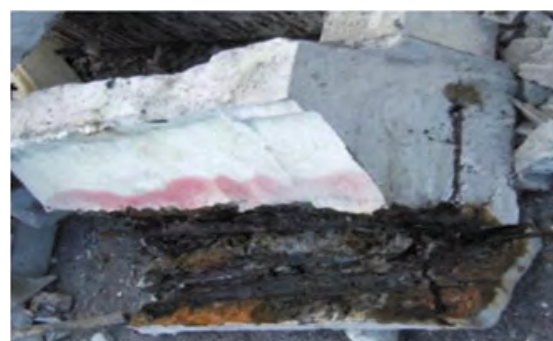
Figura 3. Ferrugem negra em viga de borda. Fonte: (11)
