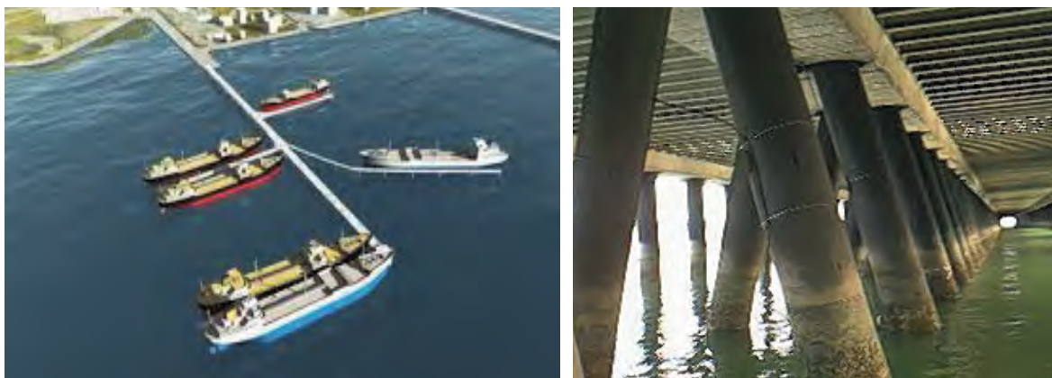
Fig. 07 – As estacas de aço de pieres de atracação de navios podem ser protegidas com anodos galvânicos de Alumínio (ABNT NBR 10387) ou por sistemas por corrente impressa, com o auxílio de um ou mais retificadores de corrente e anodos inertes instalados nas estacas com o auxílio de dispositivo especiais de fixação (DNV-RP-B401).
