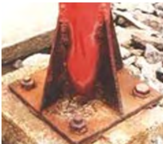
Figura 2 - Corrosão em arestas vivas nas abas de uma coluna
