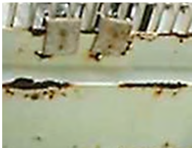
Figura 3 - Corrosão nas arestas vivas em uma Viga de aço
