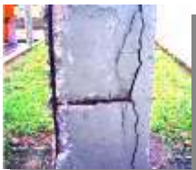
Concreto sem pintura
