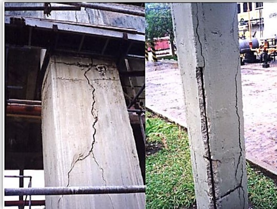
Corrosão da armadura do concreto
