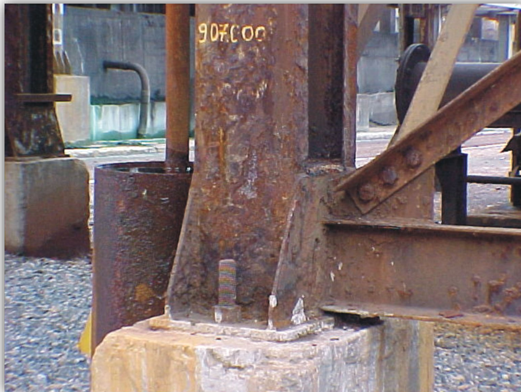
Corrosão do aço
