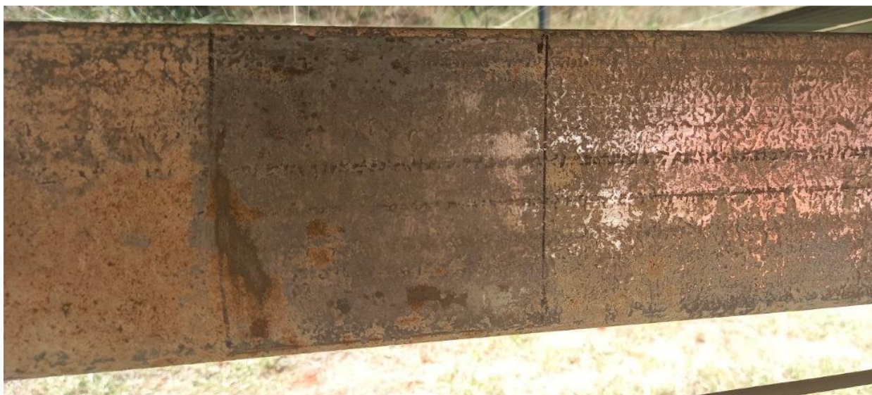
Oxidação Completa com Perda de Material
