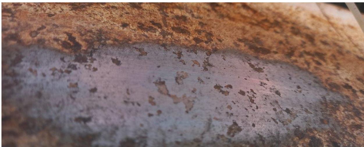
Galvanizado com Deterioração Generalizada e Severa
