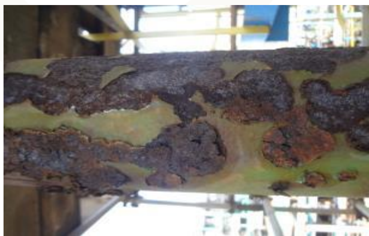
Pintura com Perda de material
