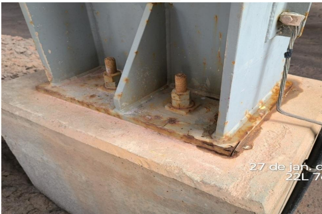
Pintura com Início de Falha
