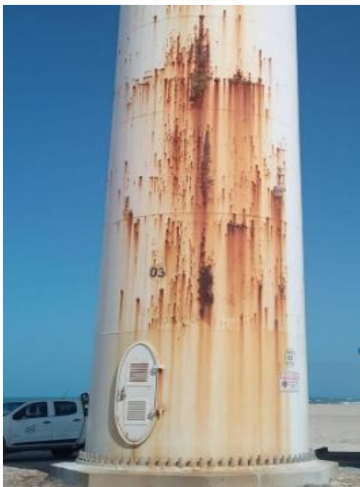
Pintura com Deterioração Severa
