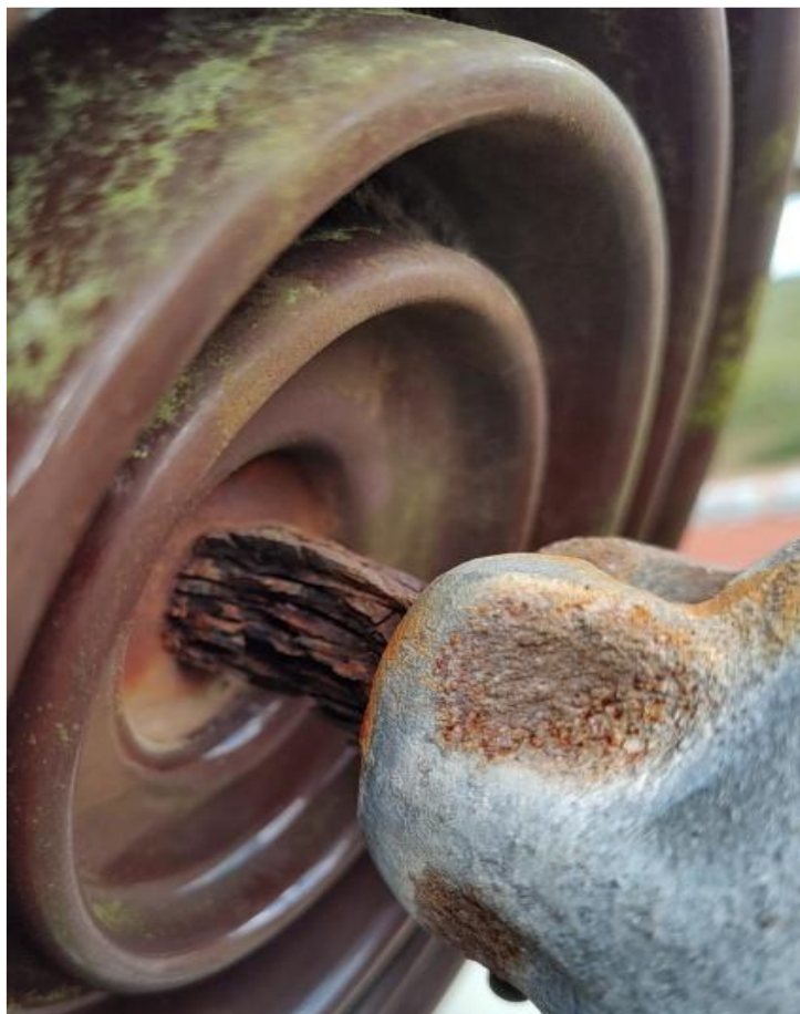
Galvanização com Grande Perda de Material
