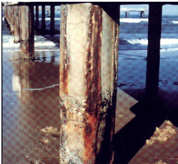
Figura 06 – Estaca de concreto armado com manchas de corrosão.
