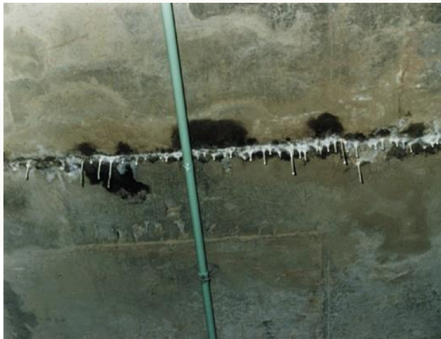
Figura 04 – Laje de concreto com presença manchas de eflorescências e com formação de estalactites resultantes da lixiviação de compostos do cimento e de sua reação química com o CO 2 atmosférico e com a presença de manchas de umidade resultante dessa reação química e de possível infiltração de água pela junta.
