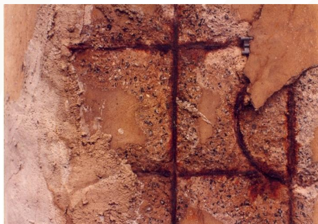
Figura 07 – Lajes de concreto armado com armadura exposta com intensa corrosão em área de concreto deslocado.
