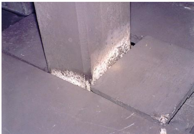
Figura 05 – Pilar de concreto, com manchas de eflorescência na parte inferior e com desagregação com exposição do agregado
