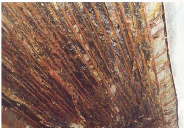
Figura 08 – Lajes de concreto armado com armadura exposta com intensa corrosão em área de concreto deslocado.
