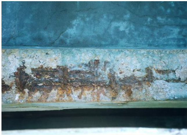
Figura 03 – Viga de concreto armado com exposição de armadura com corrosão severa.
