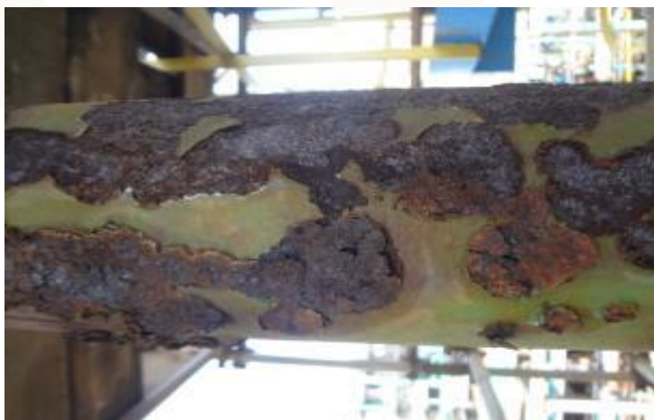
Pintura com Perda de material
