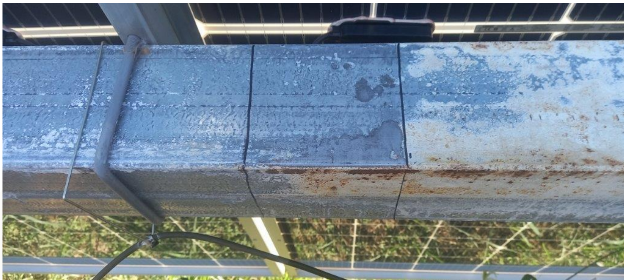
Galvanizado com Início de Perda de Passivação e Corrosão Branca
