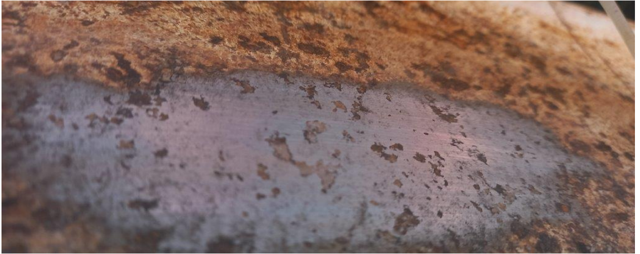
Galvanizado com Deterioração Generalizada e Severa
