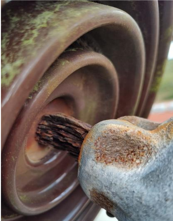
Galvanização com Grande Perda de Material
