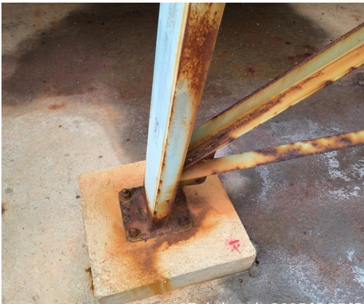
Pintura com Falha Generalizada
