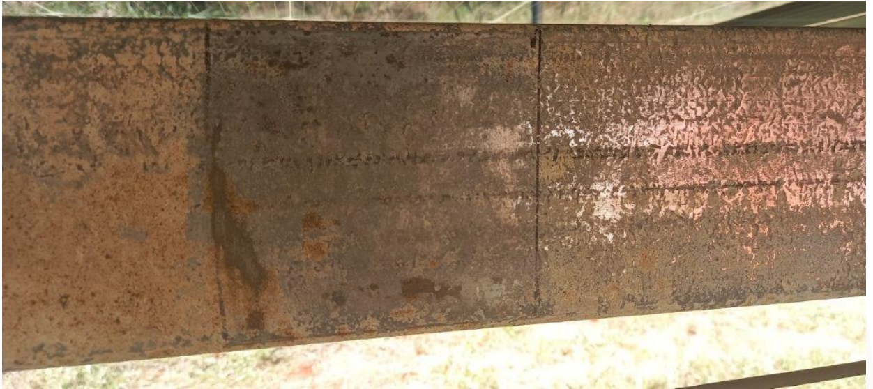
Oxidação Completa com Perda de Material
