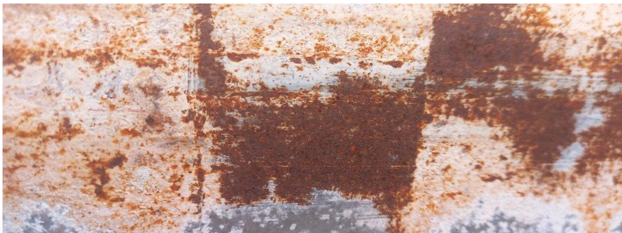
Galvanizado com Oxidação Generalizada
