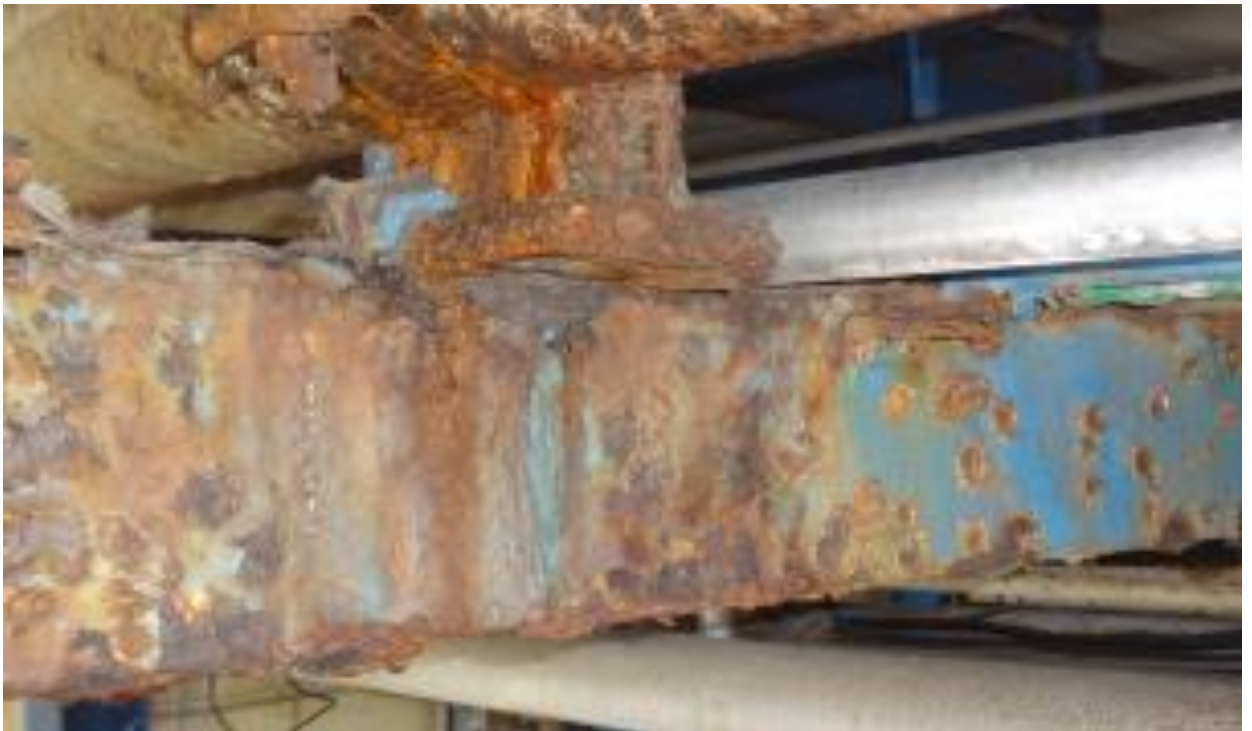
Pintura com Deterioração Completa e Perda de Material
