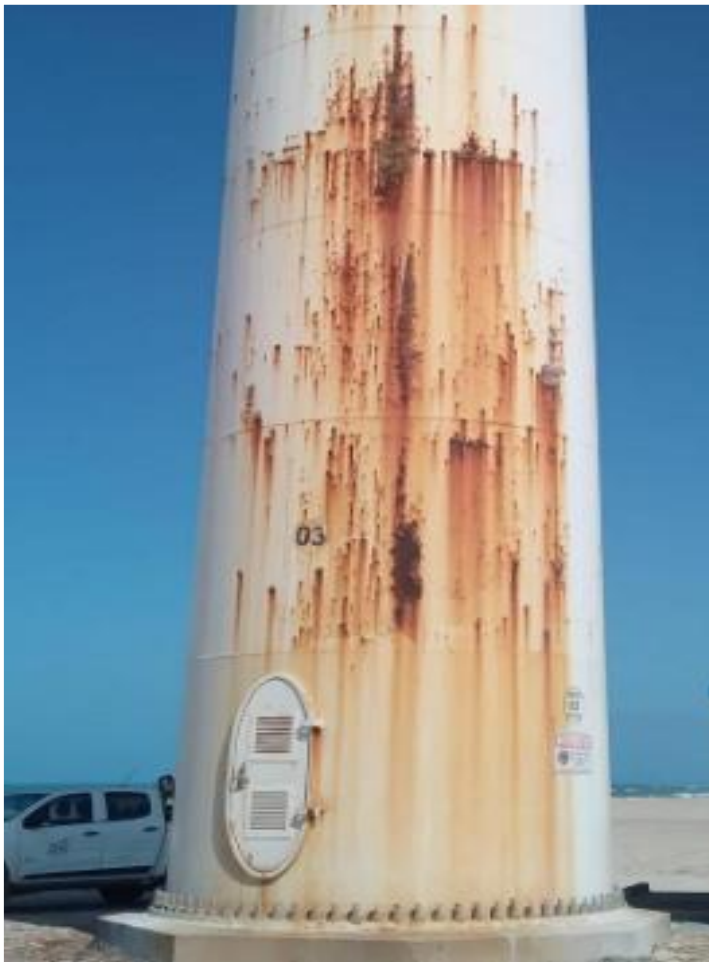
Pintura com Deterioração Severa
