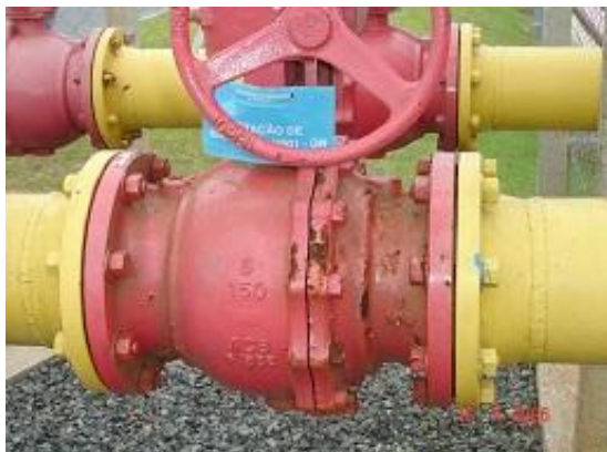
Fig. 04 - Flanges e parafusos Cortesia IEC Engenharia)
