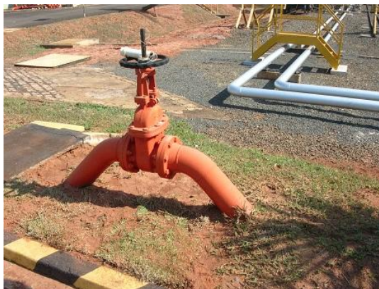
Fig. 05 - Válvula e interface aéreo/enterrado (Cortesia IEC Engenharia)
