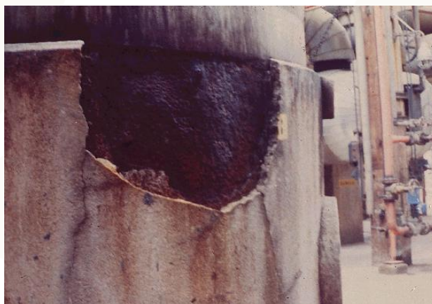
Fig.08 - Corrosão sob revestimento com concreto para proteção passiva corta fogo (Cortesia IEC Engenharia)
