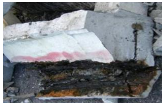
Figura 3 - Ferrugem negra em viga de borda. Fonte: (11)
