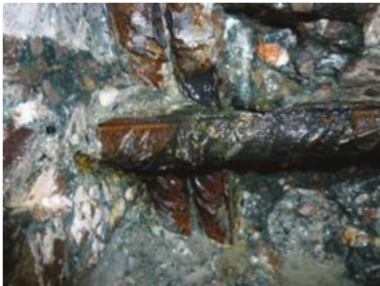
Figura 5 - Corrosão negra. Fonte: (11)
