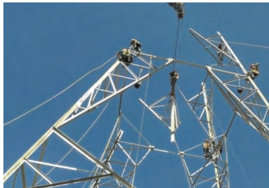
Fig. 04 - Linha de transmissão com elementos galvanizados
