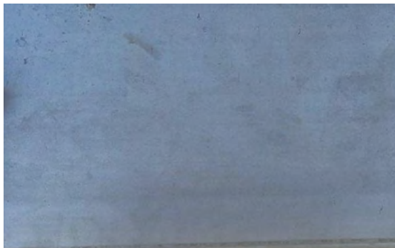
Fig. 06 – Galvanizado passivado e sem falha
