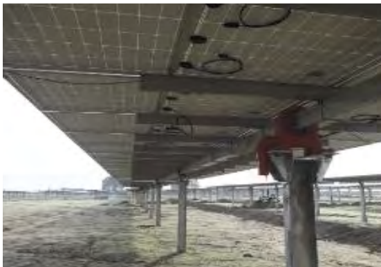
Fig. 03 - Seguidores solares (trackers) em usinas solares
