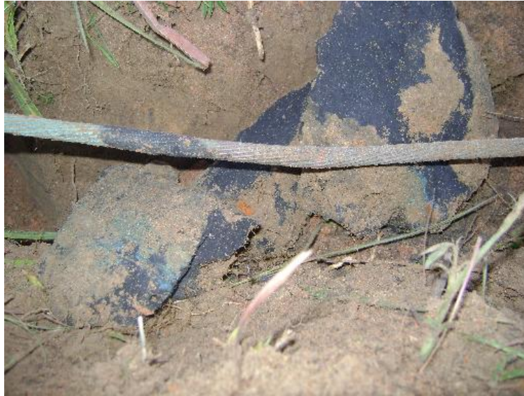
Figura 2: Petrificação juntamente com ionização do solo próximo à malha, vestígios de produto de oxidação de cobre.
