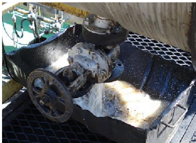
Figura 10 – Drenagem do canhão recebedor de pig após passagem de pig de arraste de água
