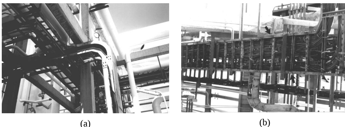
Figura 1. Vista parcial: (a) planta de produção de gases industriais. (b) Estrutura de sustentação de cabos elétricos severamente corroídos. Observam-se corrosão e deposição dos produtos de corrosão em regiões preferenciais dos banzos (inferior e superior) e dos montantes de união (indicados por setas).
