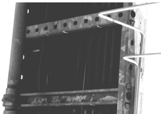
Figura 4. Montagem zincada a quente completamente íntegra.
