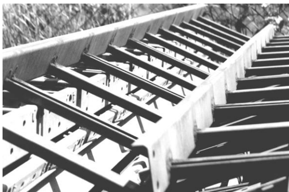
Figura 6. Peças de reposição eletrogalvanizadas, mantidas em depósito ao ar livre. Nota-se o formato extremamente favorável do perfil montante de suporte, com seção transversal em U e dobra adicional para enrijecimento, à retenção de água e umidade.
