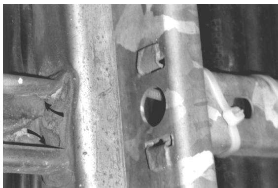
Figura 2. Material resistente à corrosão (Zn depositado a quente, à direita) comparado ao material já comprometido (Zn eletrodepositado, à esquerda). Note os diferentes processos de montagem, níveis de qualidade dos acabamentos superficiais e quantidades de produtos de corrosão. Setas indicam a região mais criticamente corroída.
