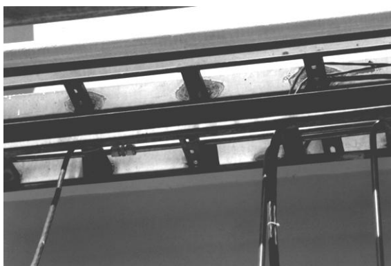
Figura 5. Detalhe do relativo confinamento do ataque corrosivo à região envolvida no processo de soldagem dos perfis.
