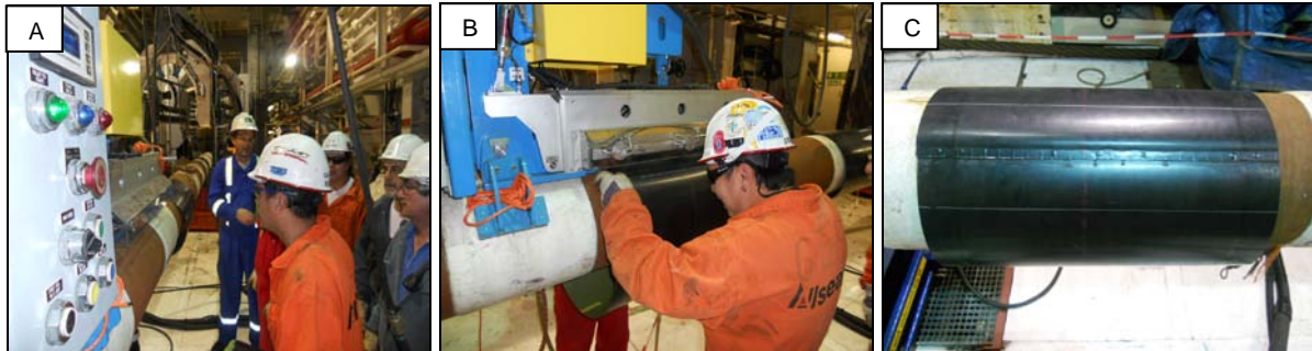
Figura 3. A. Equipamento de soldagem automática posicionado sobre o tubo do projeto GSNC Profundo & P-62; B. Execução da soldagem de uma manta de polipropileno; C. Manta soldada longitudinalmente pronta para a instalação.
