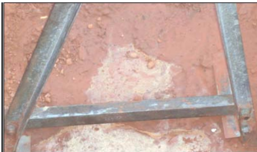
Figura 5 – Aspecto visual das grelhas da torre 85 da LT 230 kV Rio Verde/Rondonópolis, após escavação de 1,5 m. Detalhe do perfil da base da parte desenterrada da estrutura
