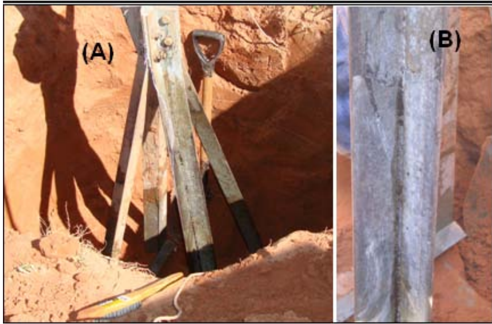
Figura 3 – Aspecto visual das grelhas da torre 38 da LT 230 kV Rio Verde/Rondonópolis, após escavação de 1,5 m. (A) Vista geral e (B) detalhe de um dos perfis
