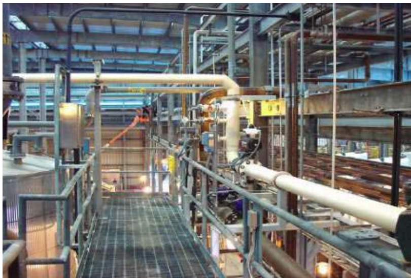
Figura 20: Tubulação de termofixo reforçado com fibra de vidro, com liner interno de ECTFE (tubulação branca).
