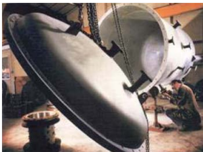
Figura 21: Tanque metálico revestido com liner de ECTFE
