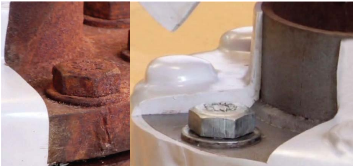
Figura 5 – comparativo entre os lados revestido e exposto ao processo corrosivo
