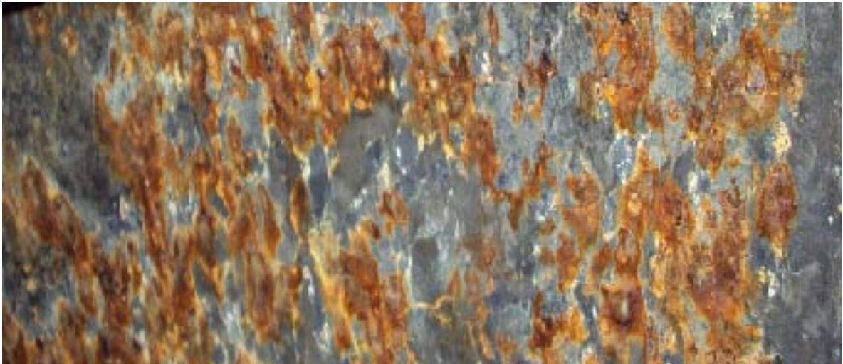
Figura 1: Corrosão química em Costado de Aço Inox 316 L
