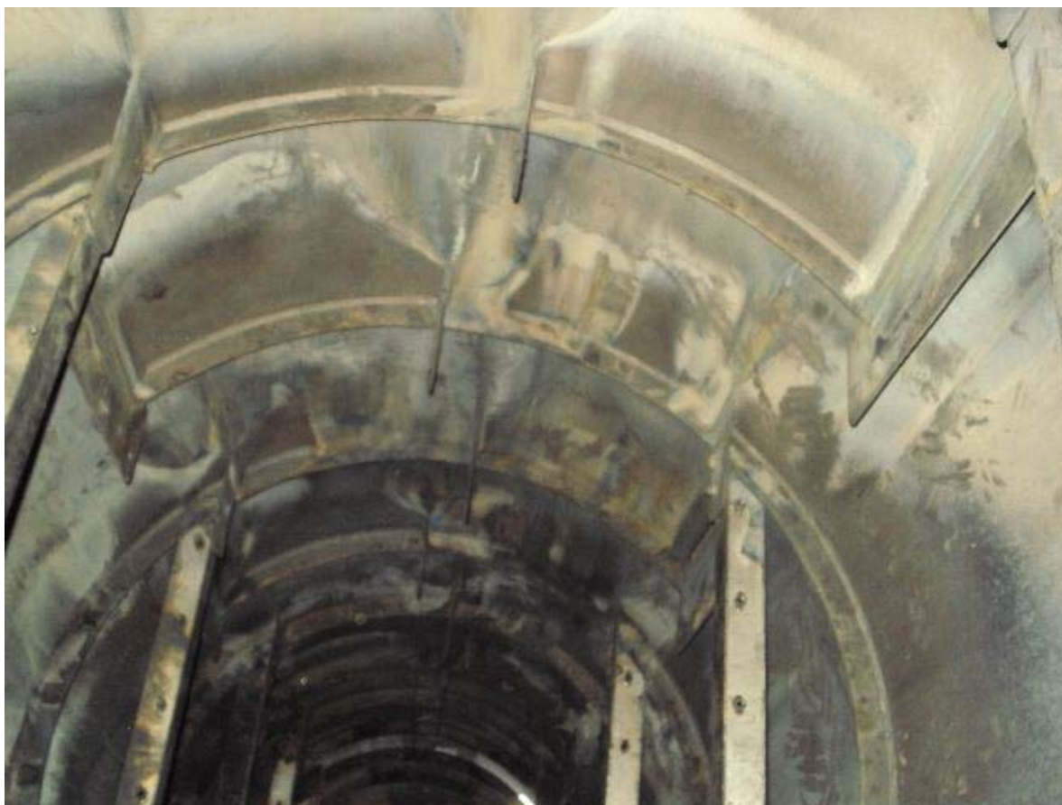
Figura 15: Revestimento intacto e sem oxidação após 3 anos
