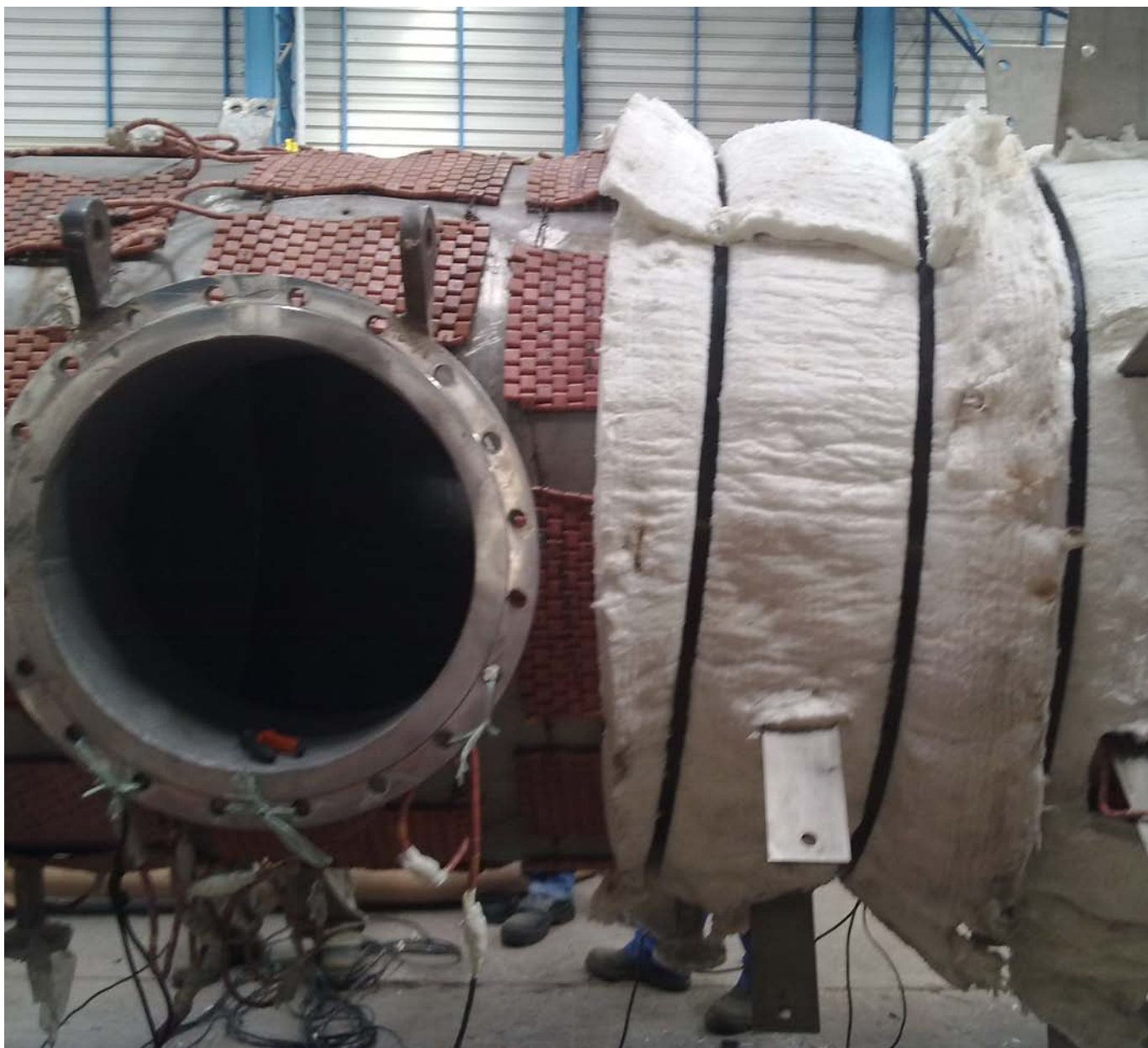
Figura 9: Detalhes da manta térmica
