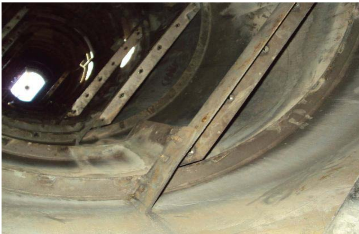
Figura 14: Costado após 3 anos em operação, revestimento intacto e sem oxidação
