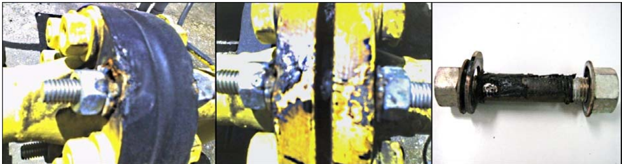
Figura 6 - Junta com flanges isolados, danificada por surto elétrico (fonte: GASMIG - 2011).
