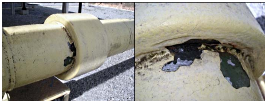
Figura 5 - Junta isolante monobloco danificada (fonte: GASMIG - 2011).
