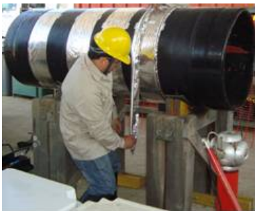
Foto 1. Segmento do Duto – 28” e 2,5m de comprimento
