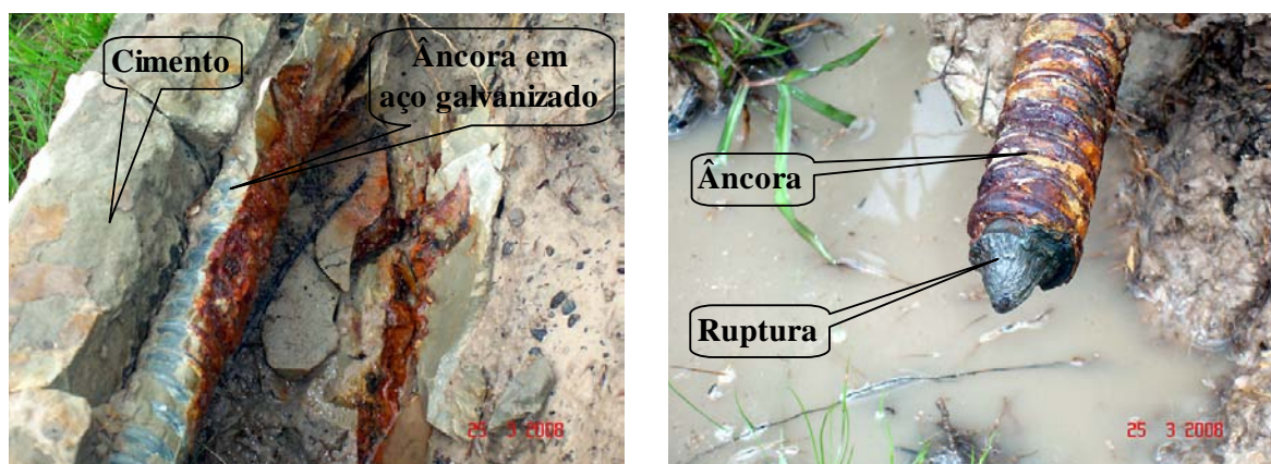
Figura 3 – Detalhe da ruptura de uma âncora por corrosão
