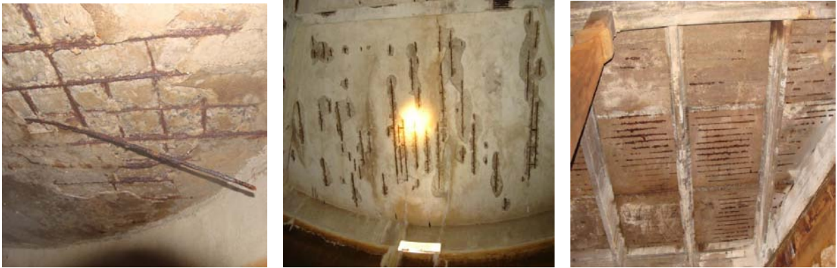
Figura 1 – Anomalias típicas de regiões com corrosão de armaduras
