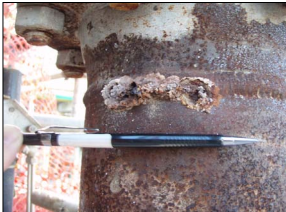
Figura 05 – Aspecto do depósito encontrado sobre a superfície externa junto à trinca.
