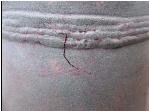
Figura 09 - Trinca na superfície externa.
