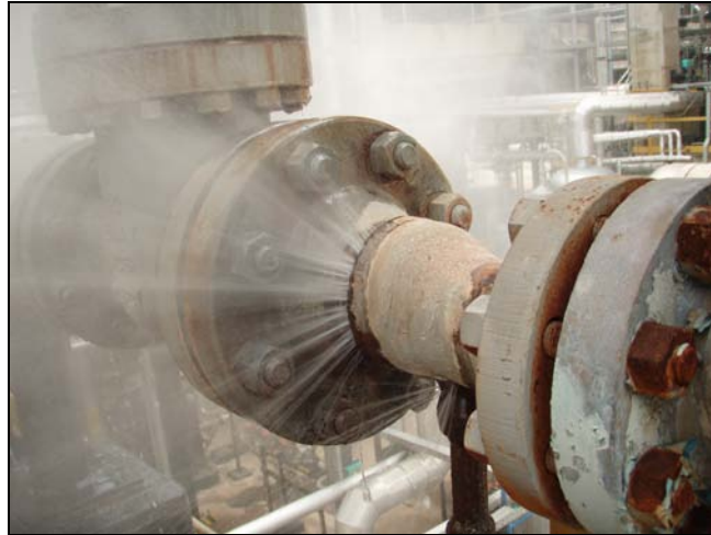
Figura 02 – Vazamento em uma das juntas soldadas da tubulação
