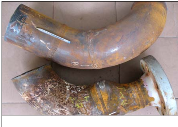
Figura 03 – Trechos da tubulação enviados para análise. Corrosão alveolar generalizada.
