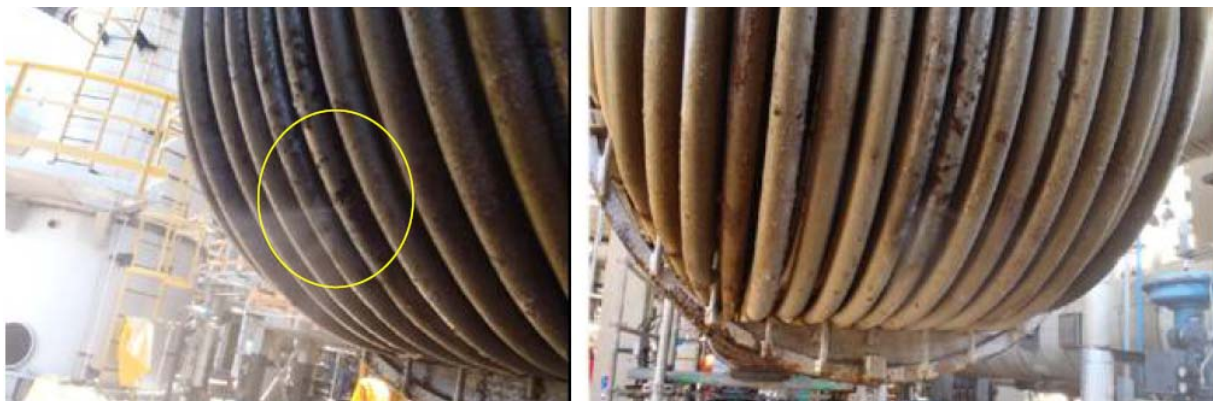
Figura 3 – Tubo vazando durante o teste hidrostático do feixe tubular (2) .
