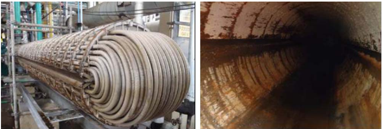
Figura 2 – Feixe tubular após abertura do equipamento e casco lado interno (2) .
