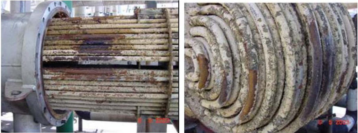
Figura 1 – Depósitos sobre os tubos do trocador de calor (ano de 2003) (2) .
