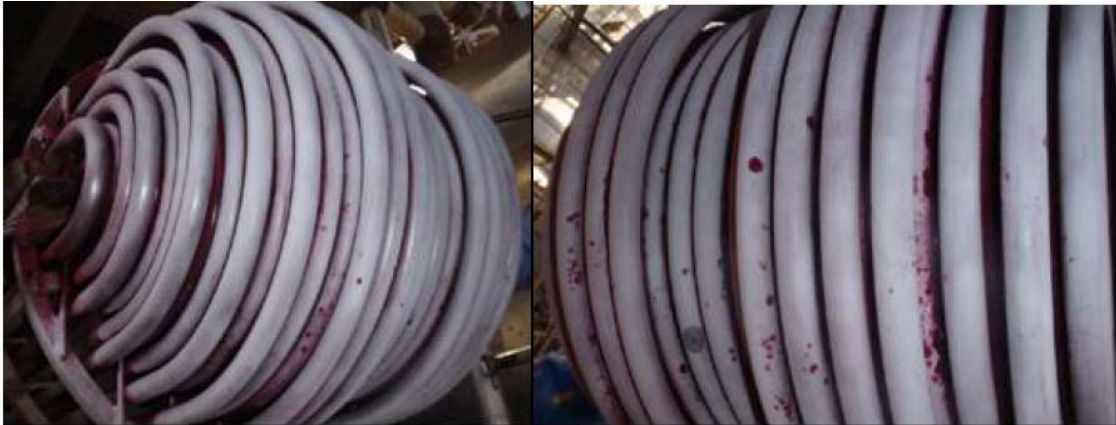
Figura 6 – Feixe tubular com indicações no ensaio de LP – presença de pites na região inferior (fev/2012) (2) .
