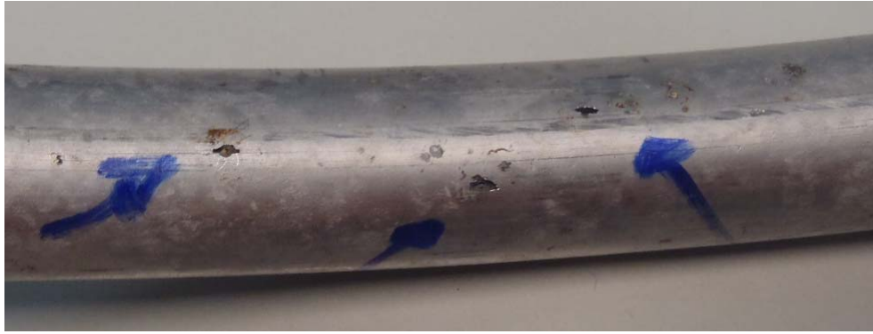
Figura 8 – Detalhe do tubo 6 – presença de pites e corrosão na região inferior da curva em U (fev/2012) (2) .
