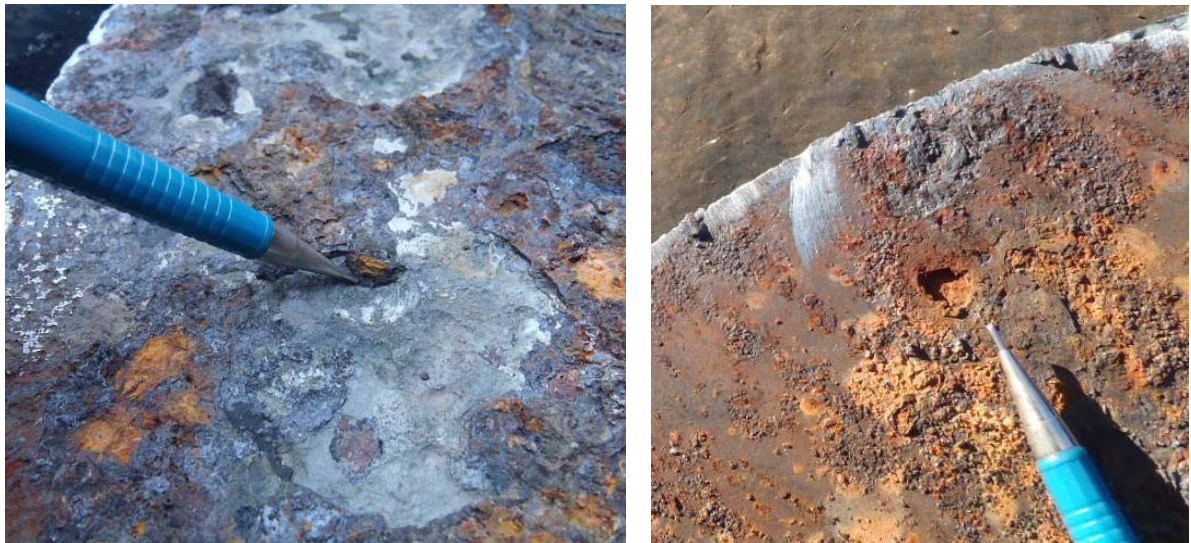
Figura 6 – Fotografia de detalhe da parte posterior da chapa de fundo a) região corroída e b) alvéolo localizado.
