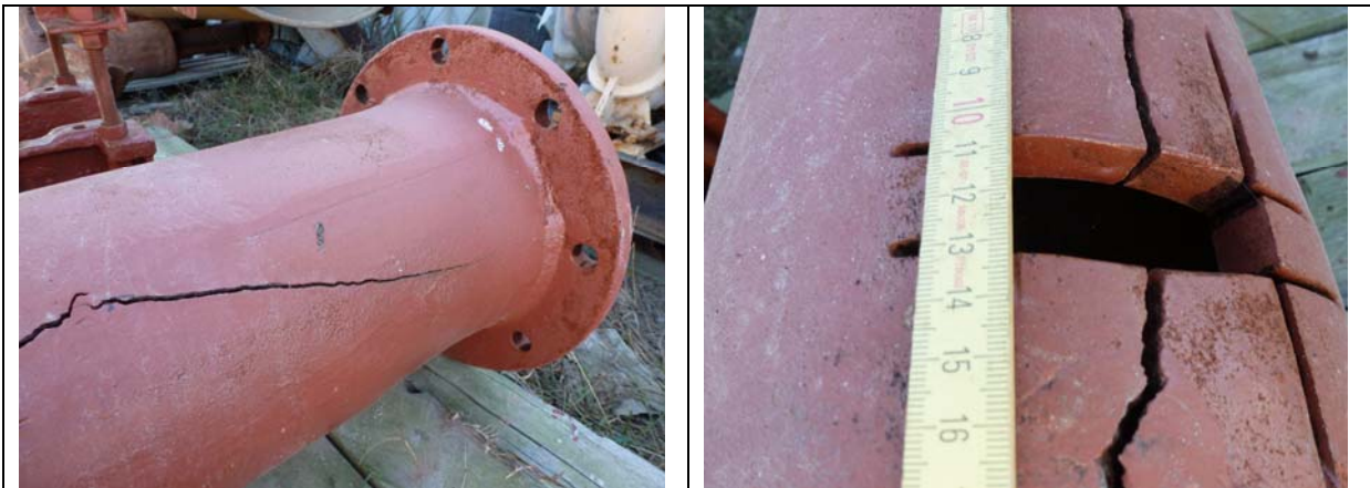
Ilustración 3 - Agrietamiento de accesorios de fundición gris
