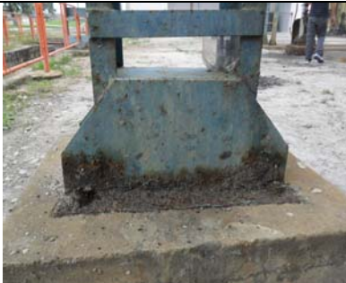
Figura 8 – Base de andaime de sustentação de tubulações.
