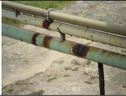
Figura 6 – Tubulação de água de uso geral, trecho na área próxima a equipamentos.
