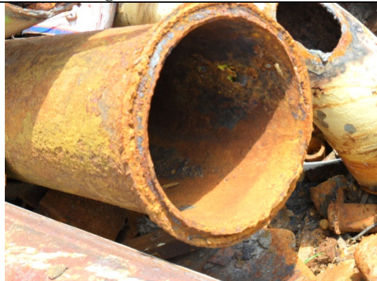
Figura 2 – Parte da tubulação da coluna do processo de sulfitação retirada após perfuração da parede do tubo.
