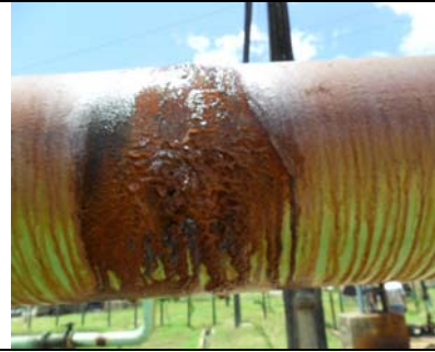
Figura 7 – Tubulação de água de uso geral, trecho sobre o tanque de armazenamento de água.
