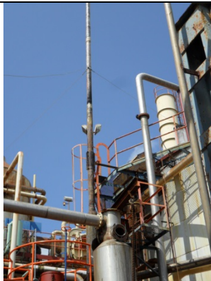
Figura 1 – Tubulação da coluna de sulfitação durante o período de moagem.
