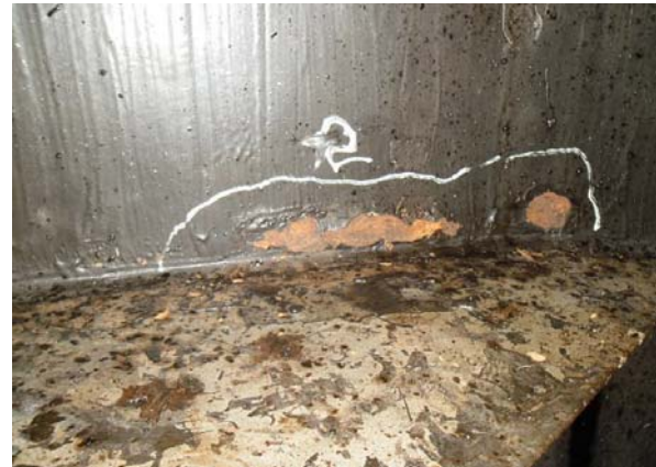
Figura 8 - Um dos defeitos identificados.
