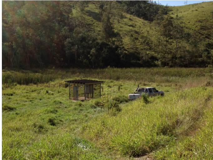
Figura 2 – Retificador instalado em região remota
