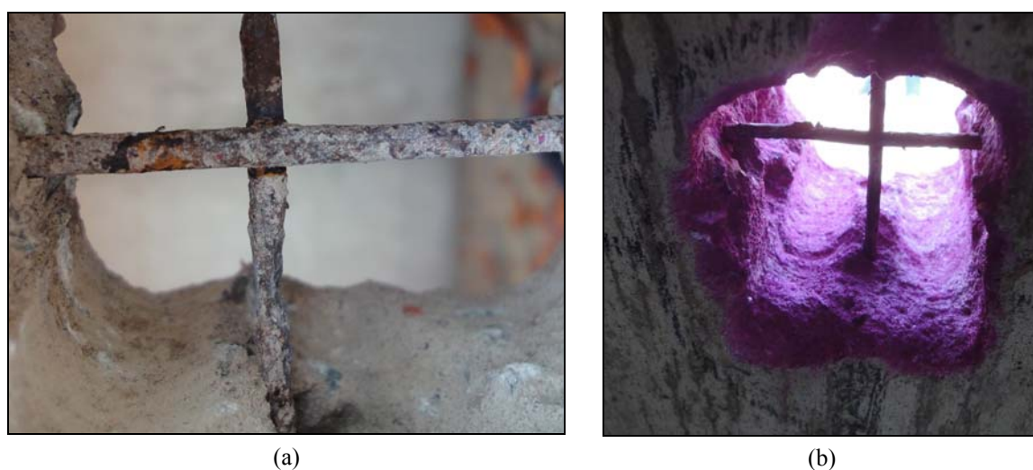
Figura 5 - Armadura recém-exposta com manchas de coloração preta e castanho-alaranjada em áreas localizadas da superfície (incluindo a intersecção dos fios), indicativas de despassivação (a). Após ensaio de carbonatação, indicação de que a região de embutimento da armadura não estava carbonatado (superfície de coloração rósea) (b).
