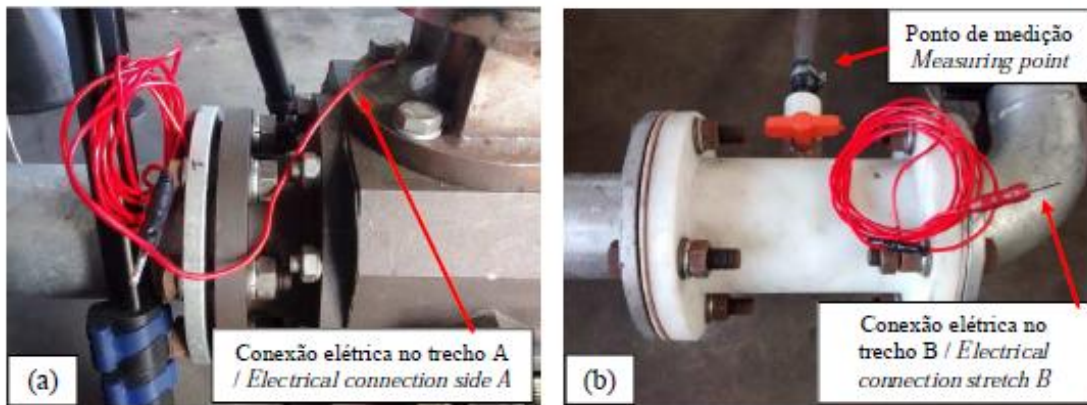
Figura 6: Sistema de medição de potencial
