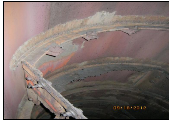
Foto 4b - Corrosão no nível dos pratos
