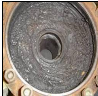
Foto 1b- voluta de bomba com corrosão interna
