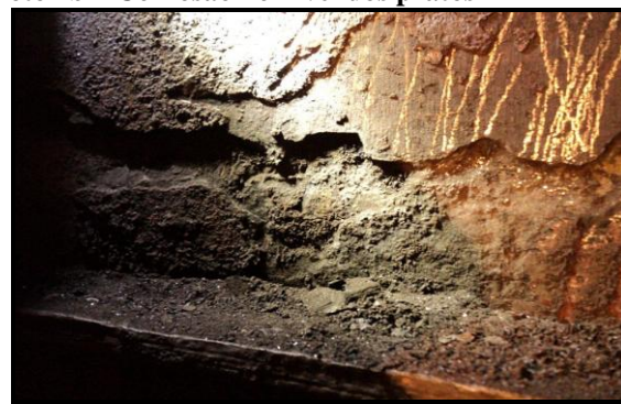
Foto 4d - detalhe da corrosão no nível dos pratos
