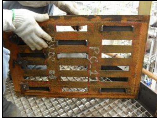
Foto 3b – prato da torre G, ausência de válvulas.
