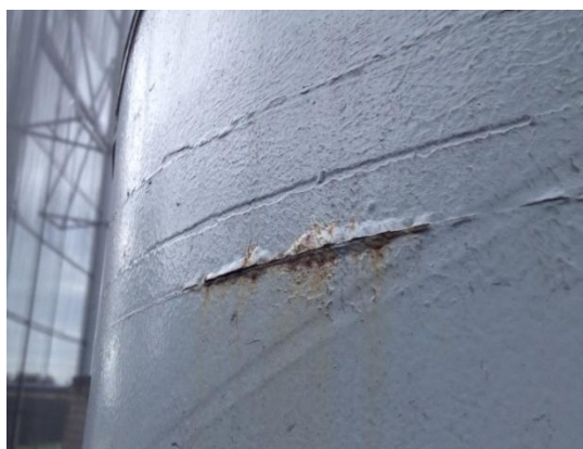
Figura 9 - Torre 06: Ponto foco de corrosão com a tinta já começando a deslocar em função da formação de óxido de ferro com maior volume
