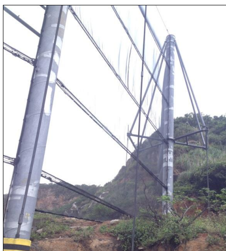
Figura 7 – Torres 09 e 10 – Galvanizadas a fogo
