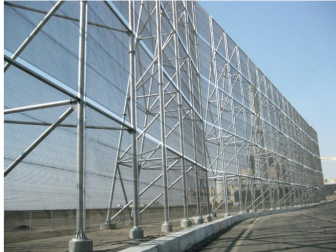
Figura 1 – Wind Fence galvanizada de proteção para pilha de carvão em Pueblo, Colorado, EUA.
