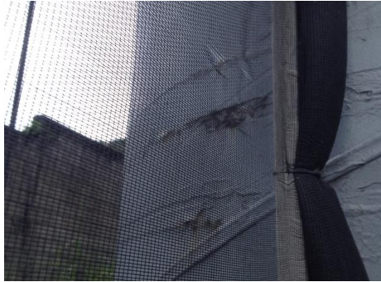
Figura 10 - Torre 04: Diversos pontos foco de corrosão
