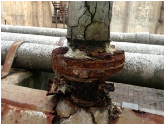
Figura 3: Este é um exemplo de um caso severo de corrosão em um flange, onde a manutenção do equipamento já não será possível.
