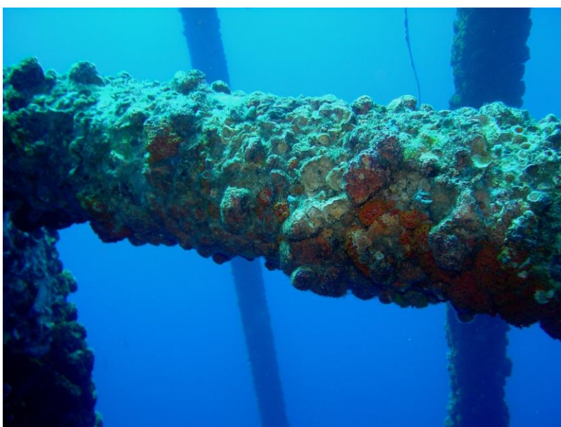
Foto 02 – Exemplo de incrustação em contraventamento a 15 m de profundidade.
