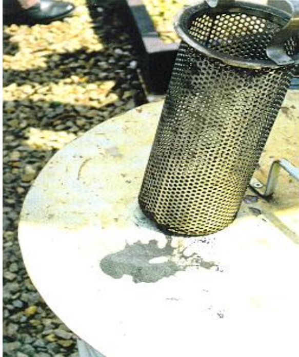
Figura 3 – Filtro com partículas finas, de cor cinza, formado pelo produto de corrosão do CO 2
