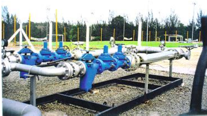
Figura 1 – City-gate de dois tramos com filtro válvulas de controle (azul) e válvula reguladora de pressão
