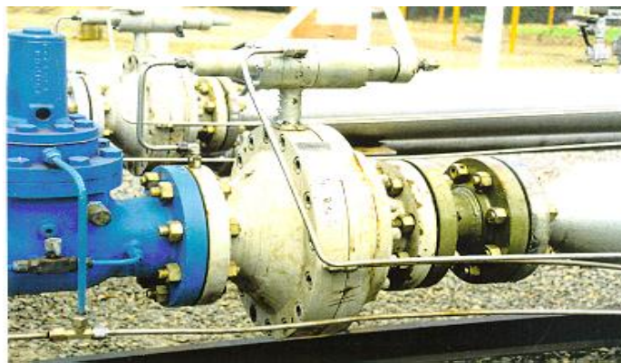
Figura 2 – Válvula controladora de pressão (cor cinza) e suas linhas de instrumentação cujo funcionamento fica prejudicado na presença de partículas sólidas no gás
