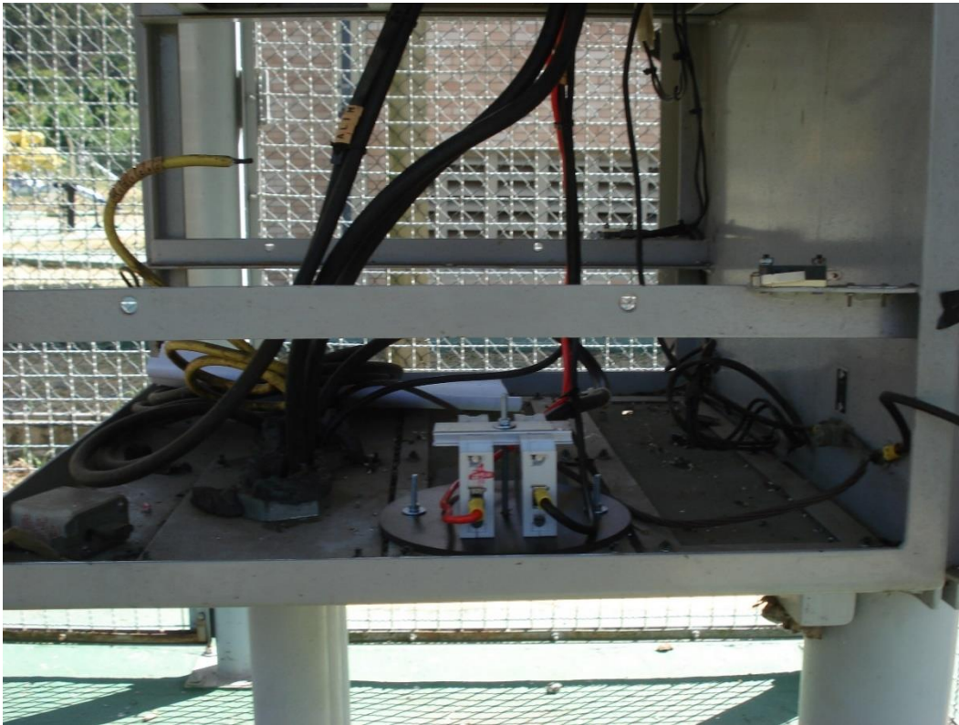
Figura 2 – Disjuntores instalados no retificador – visão interna
