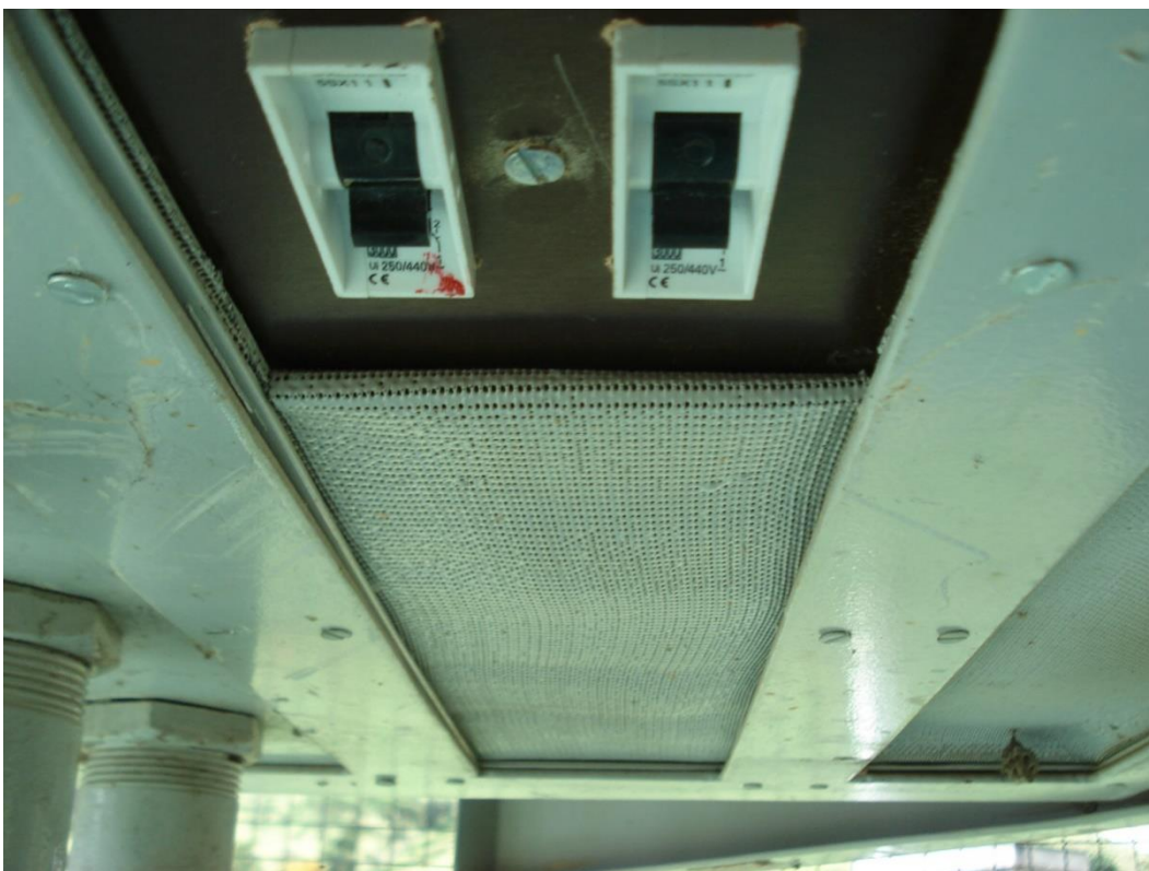
Figura 3 – Disjuntores instalados no retificador – visão externa inferior
