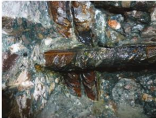
Figura 5. Corrosão negra. Fonte: (11)
