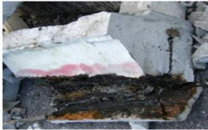
Figura 3. Ferrugem negra em viga de borda. Fonte: (11)
