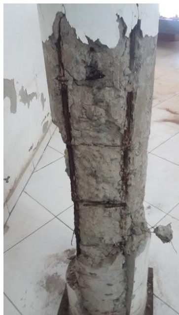
Figura 2 - Corrosão em pilar.
